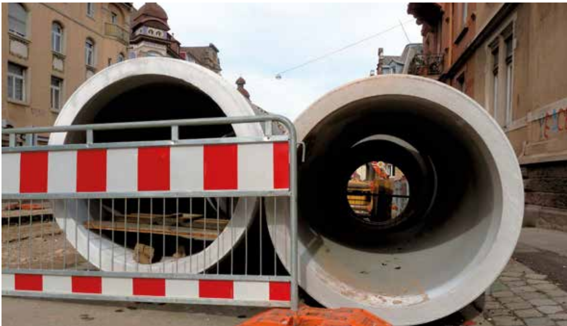
Bei der Sanierung maroder Abwasseranlagen muss mehr Geld in die Hand genommen werden.
